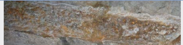
Stark korrodierter Walzträger in der Decke.
